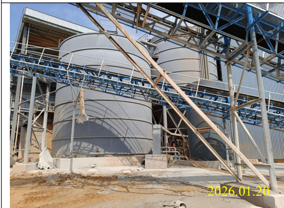
已建设的生产废水处理设施
