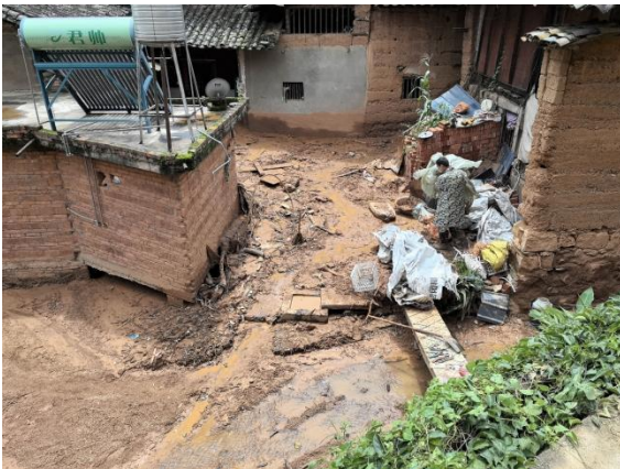
照片 3-5 泥沙冲入居民房屋②
