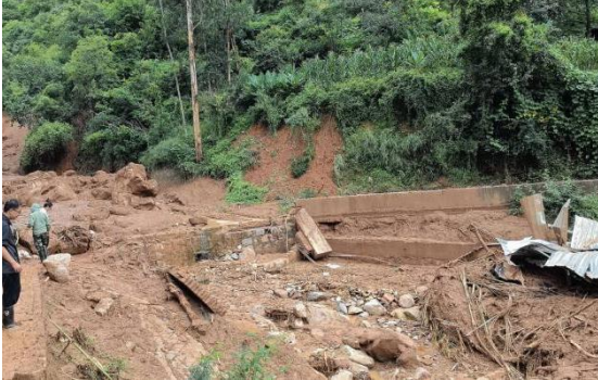
照片 3-1 沟口位置泥石流阻塞涵洞漫过道路
