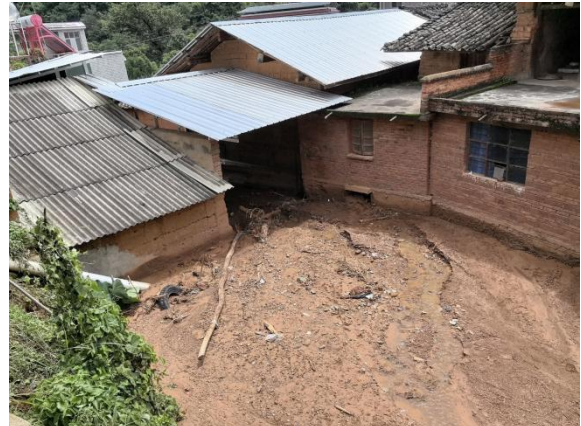
照片 3-6 下游涵洞阻塞后被冲毁的房屋
