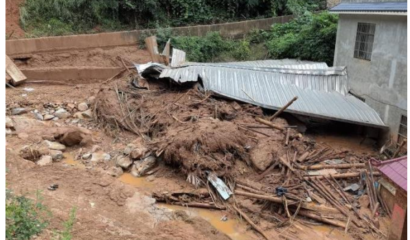
照片 3-2 养殖房被冲毁
