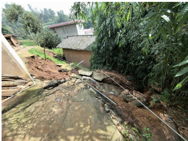
照片 3-5 H3 滑坡垮塌后缘照片
