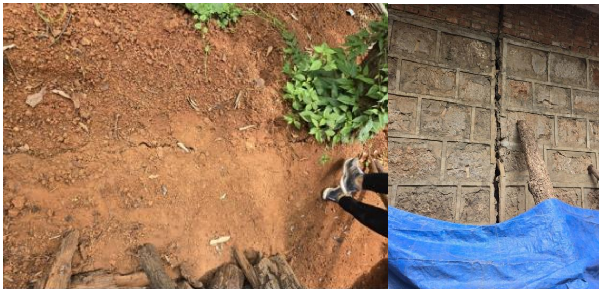
图 3.3-1 滑坡坡体裂缝及挡墙开裂现场照片
