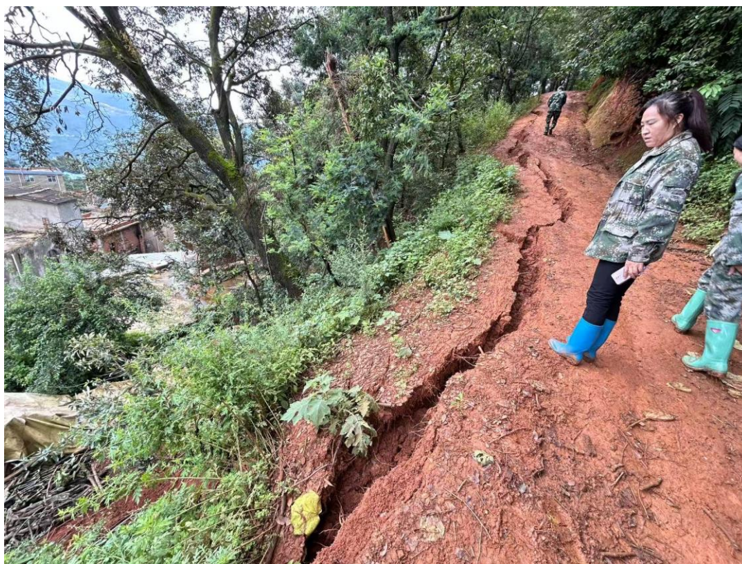
图 3.3-1 大黄梨树村滑坡后缘贯通张拉裂缝
