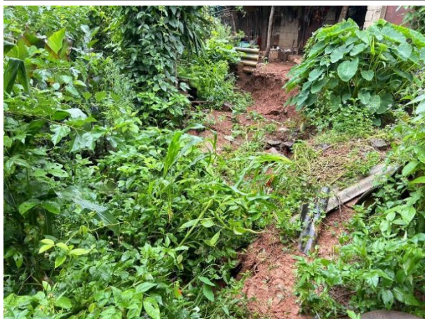
图4.3-1 校场坝村滑坡后缘张拉下错裂缝
