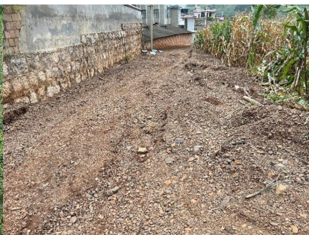
图 3.3-2 沙沟泥石流淤堵居民区公路
